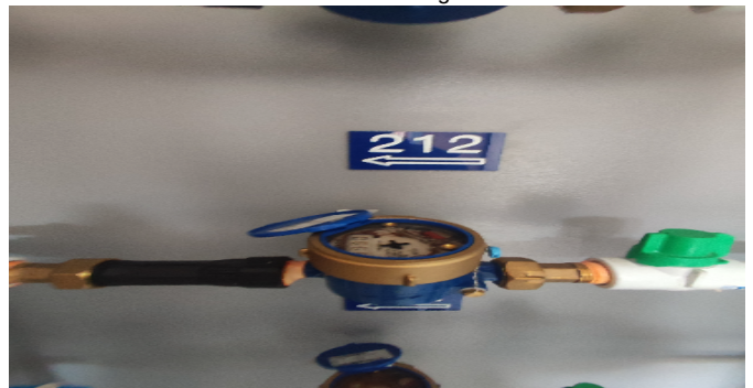
Contador de Agua
