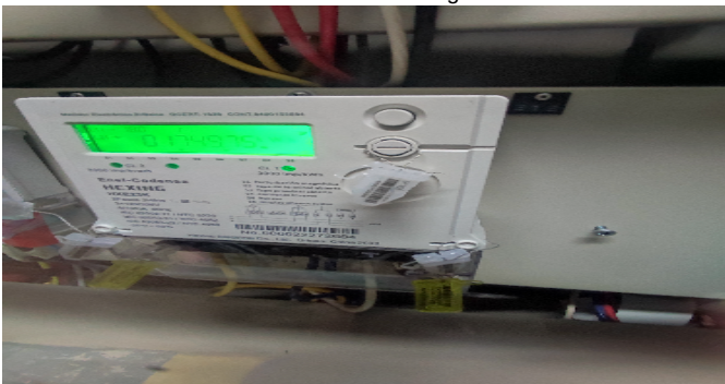
Contador de Energia
