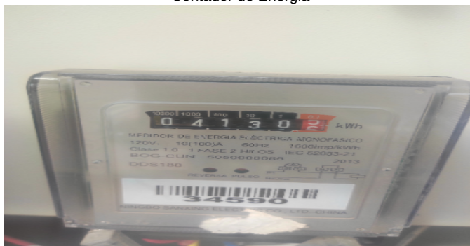
Contador de Energia
