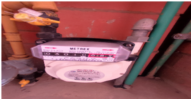
Contador de Gas
