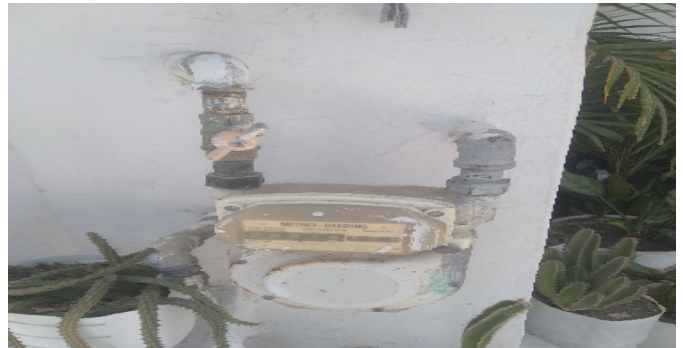
Contador de Gas
