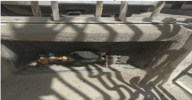
Contador de Agua
