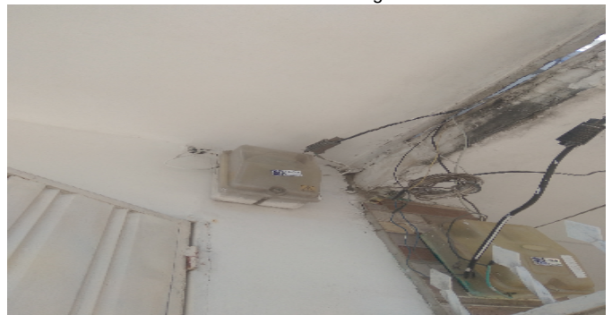
Contador de Energia
