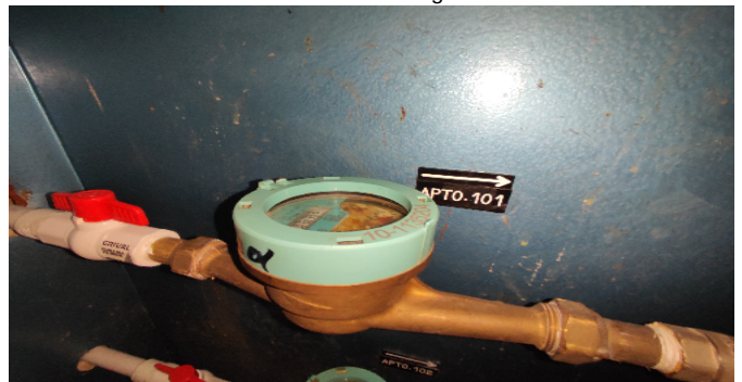
Contador de Agua
