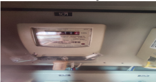
Contador de Energia
