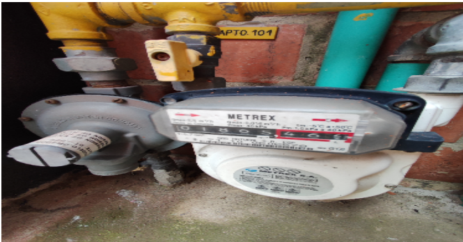
Contador de Gas
