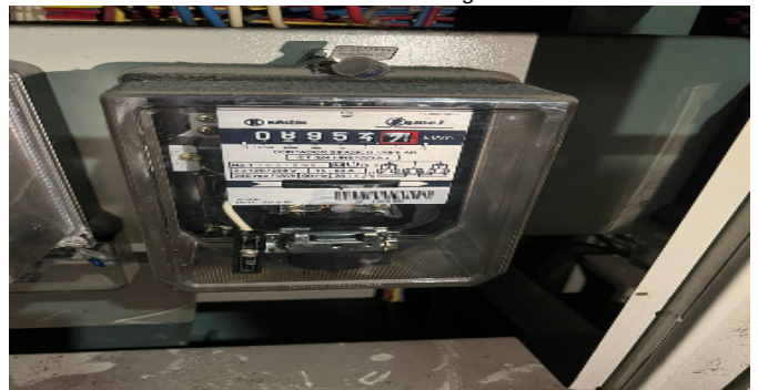
Contador de Energia
