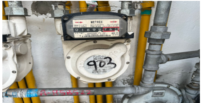
Contador de Gas
