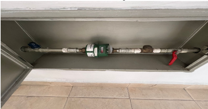
Contador de Agua
