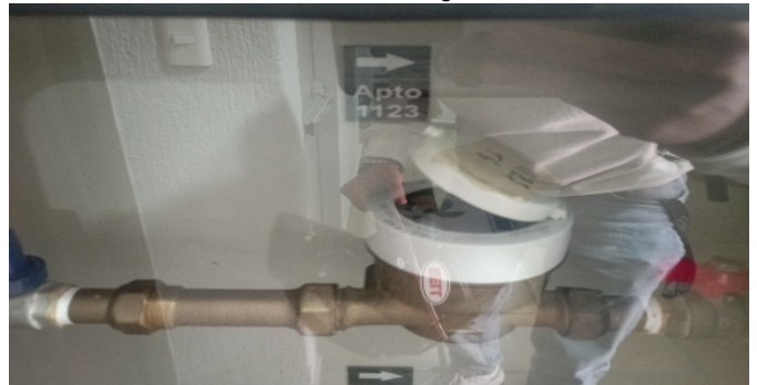
Contador de Agua
