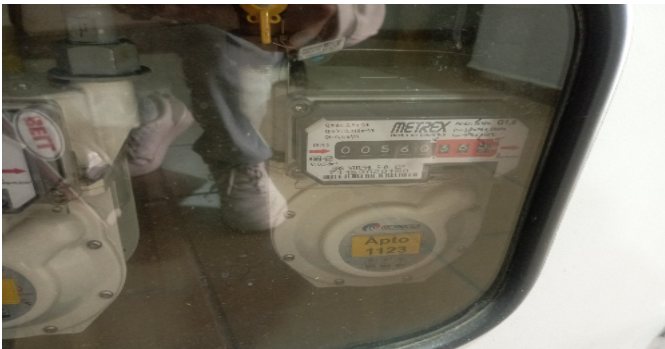
Contador de Gas
