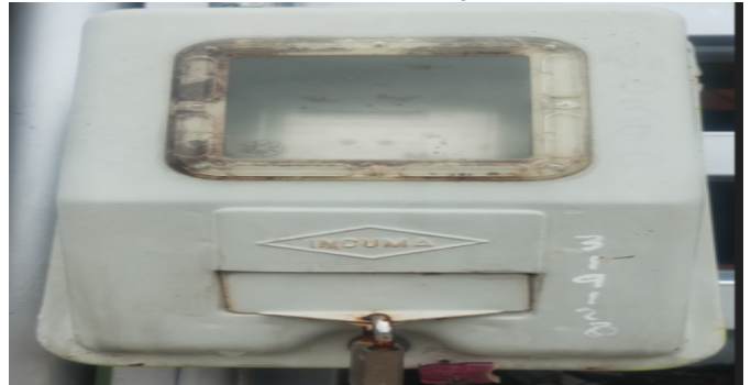
Contador de Energia
