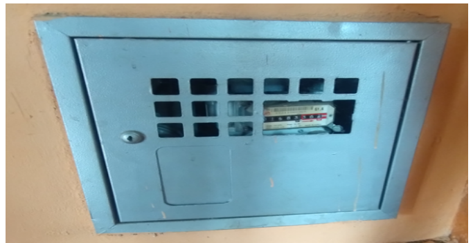
Contador de Gas
