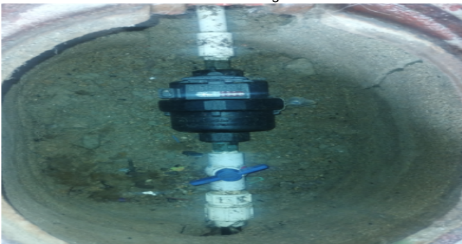
Contador de Agua
