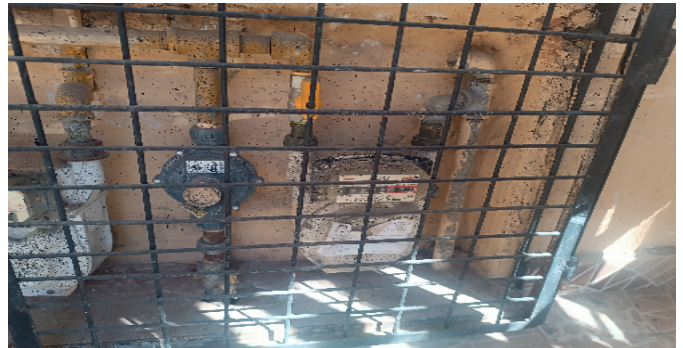
Contador de Gas
