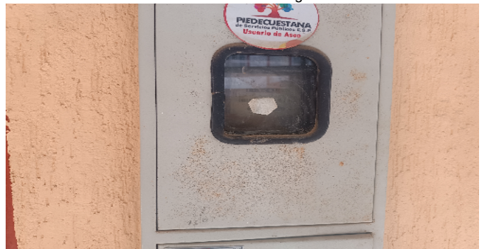
Contador de Energia
