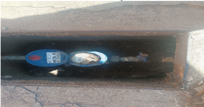
Contador de Agua
