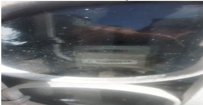
Contador de Energia
