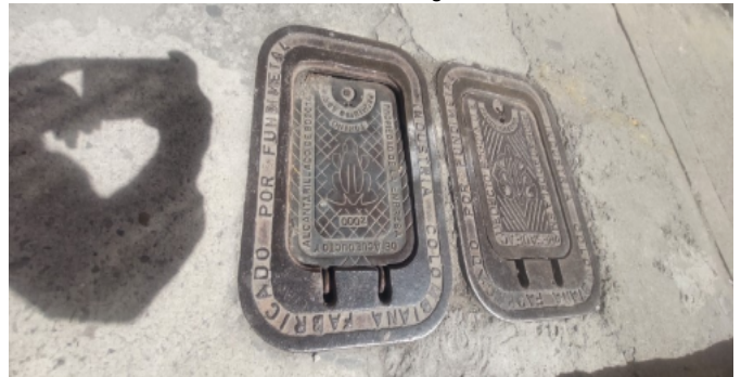
Contador de Agua
