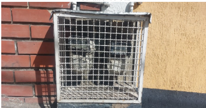
Contador de Gas
