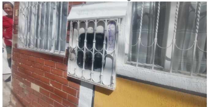
Contador de Energia
