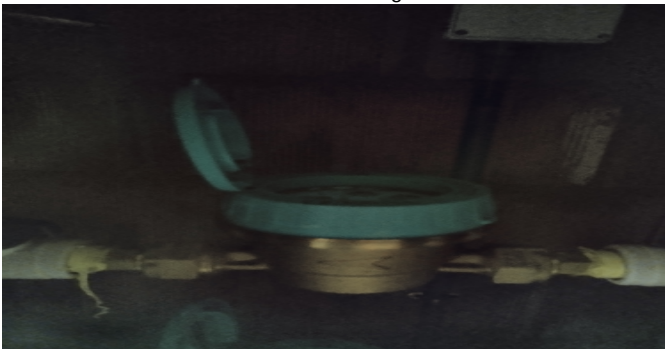
Contador de Agua
