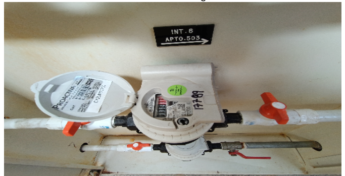
Contador de Agua
