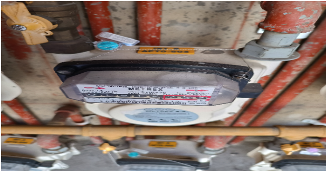
Contador de Gas
