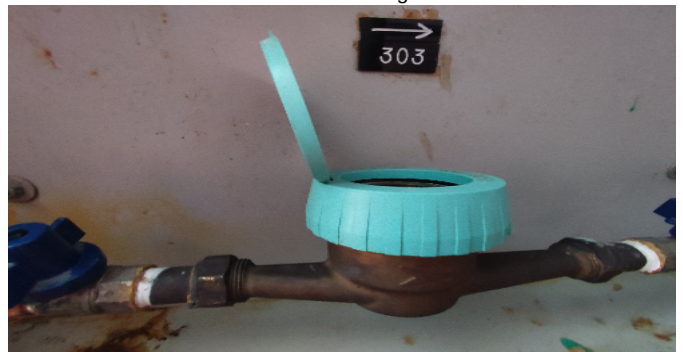
Contador de Agua
