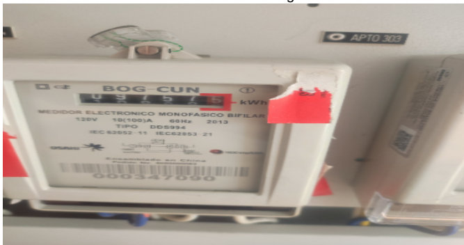
Contador de Energia
