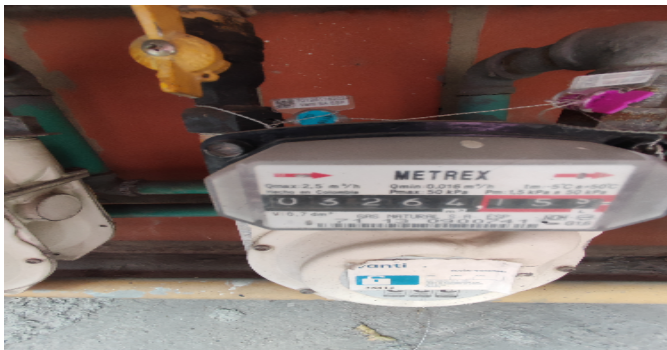
Contador de Gas
