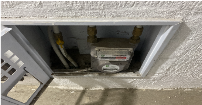
Contador de Gas
