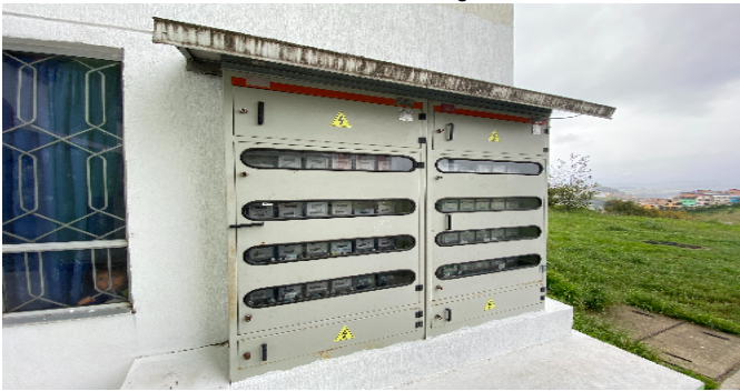
Contador de Energia
