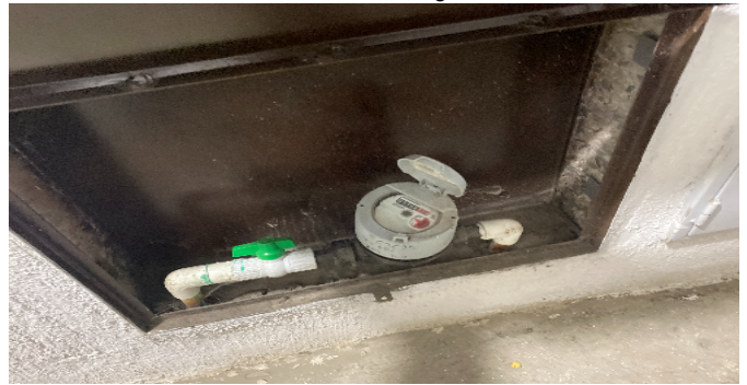
Contador de Agua
