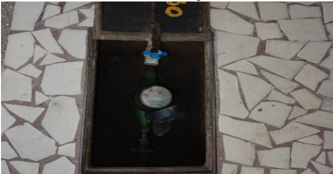
Contador de Agua
