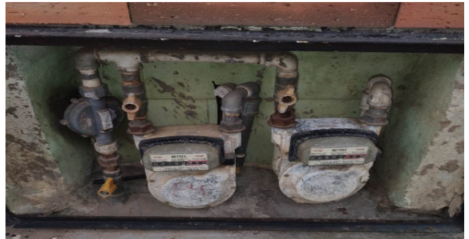
Contador de Gas
