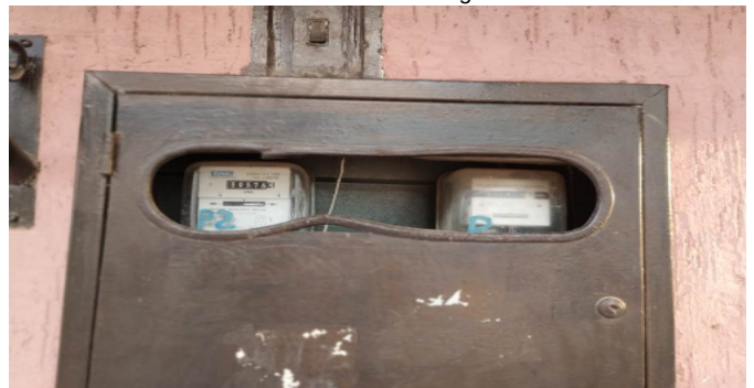
Contador de Energia
