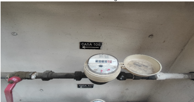
Contador de Agua
