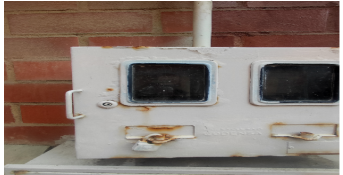
Contador de Energia
