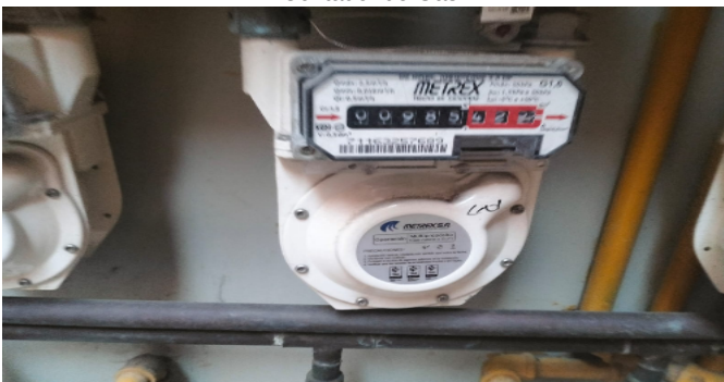
Contador de Gas
