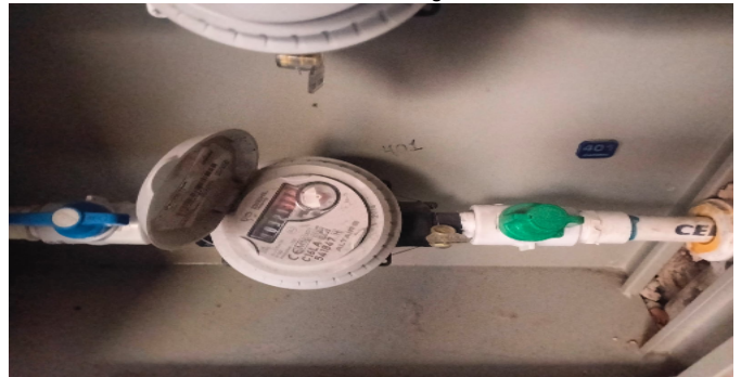
Contador de Agua
