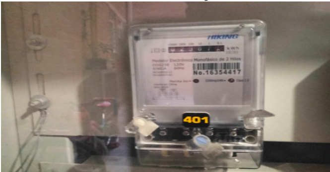
Contador de Energia
