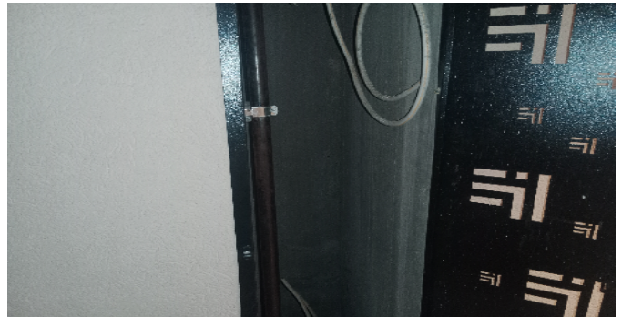
Contador de Gas
