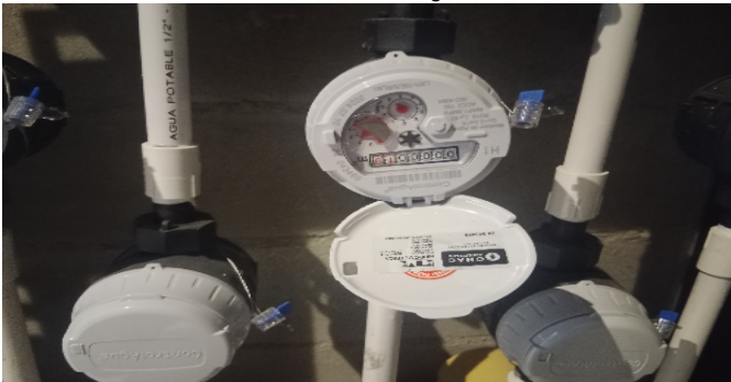
Contador de Agua
