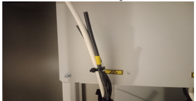
Contador de Energia
