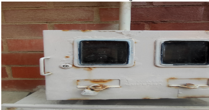
Contador de Energia
