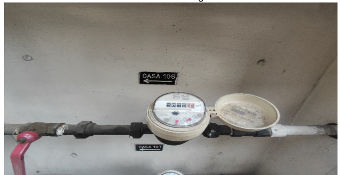
Contador de Agua
