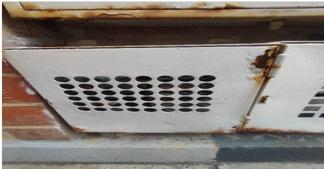
Contador de Gas
