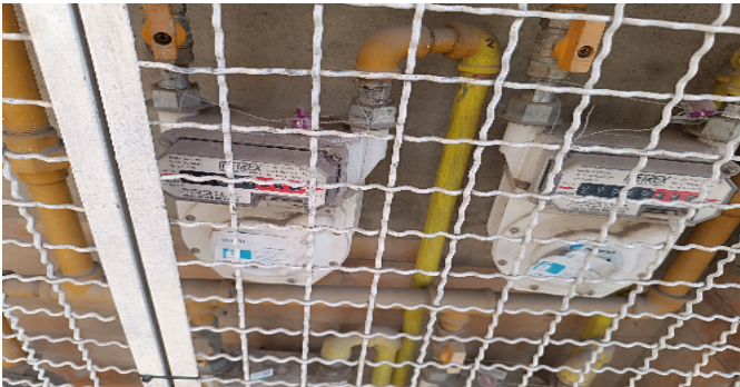
Contador de Gas
