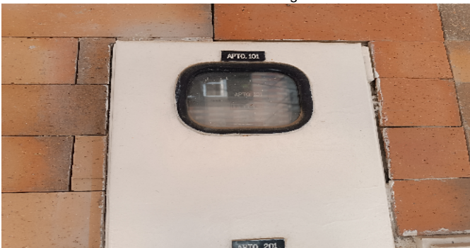
Contador de Energia
