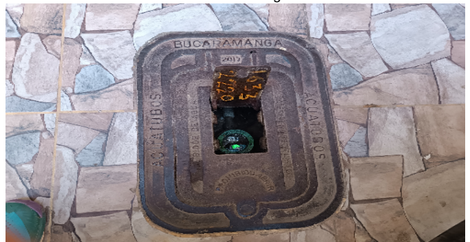
Contador de Agua
