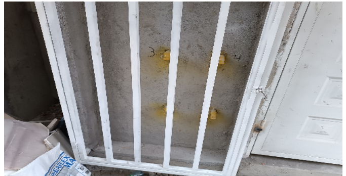
Contador de Gas
