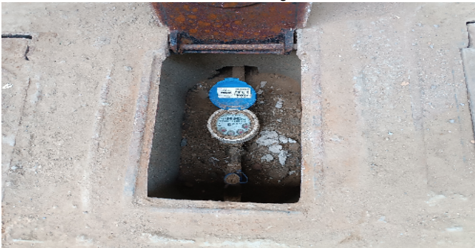
Contador de Agua
