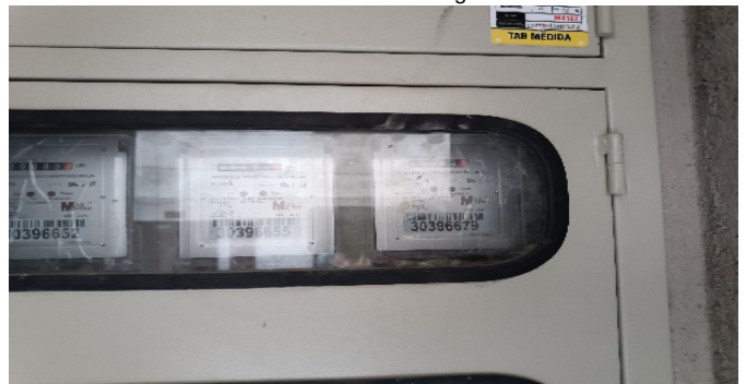
Contador de Energia
