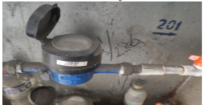
Contador de Agua
