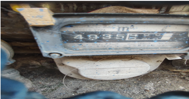
Contador de Gas
