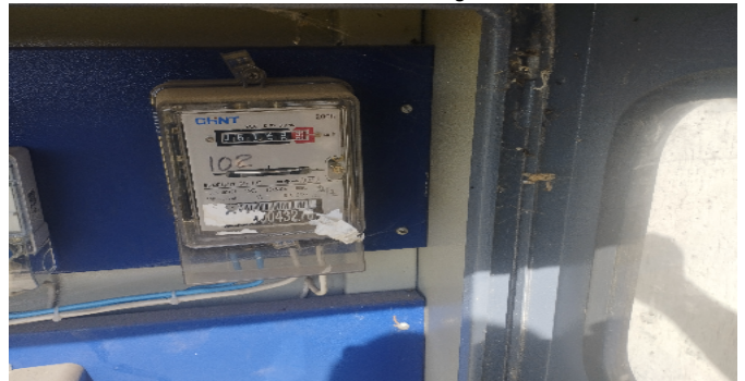
Contador de Energia
