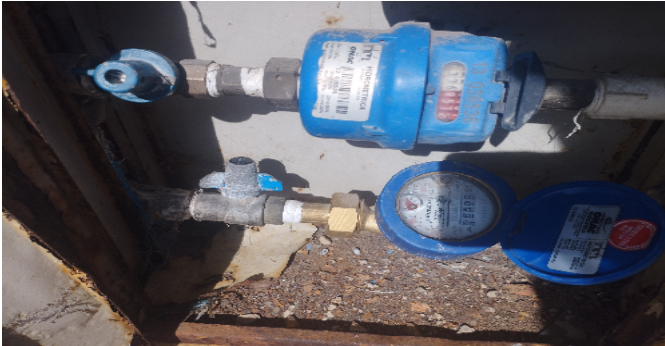
Contador de Agua
