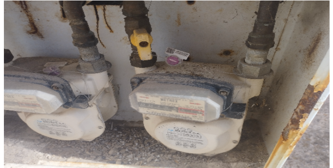
Contador de Gas
