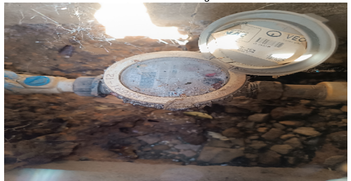
Contador de Agua
