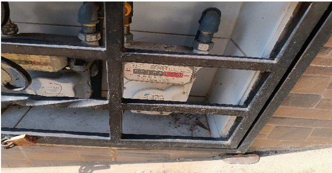
Contador de Gas
