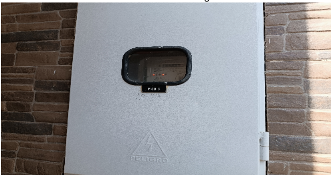
Contador de Energia
