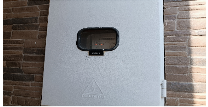
Contador de Energia
