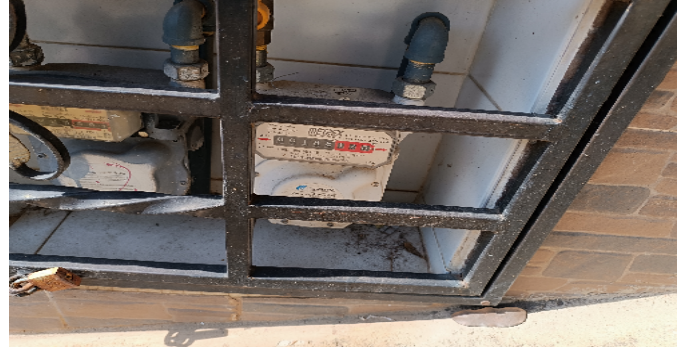
Contador de Gas
