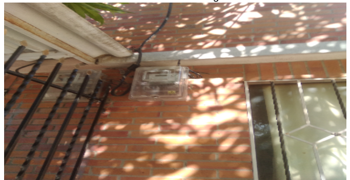
Contador de Energia
