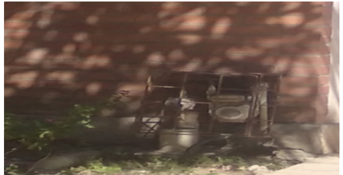
Contador de Gas
