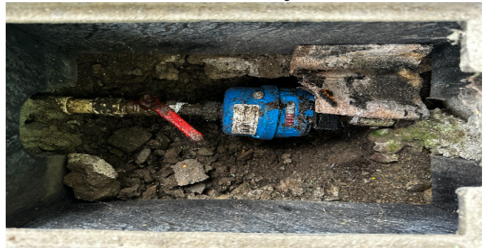
Contador de Agua
