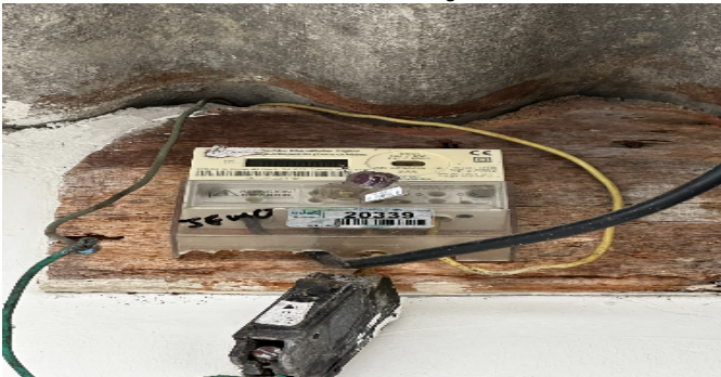
Contador de Energia
