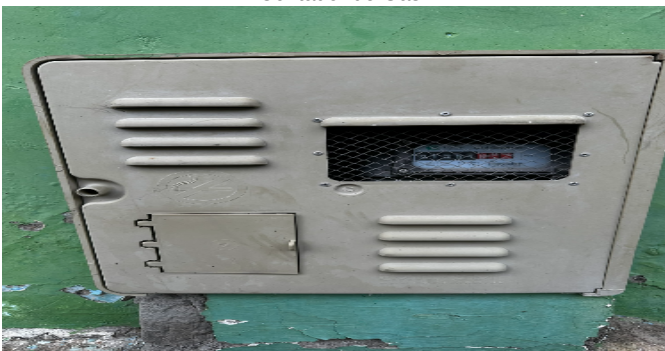
Contador de Gas
