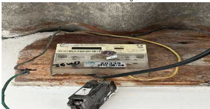
Contador de Energia
