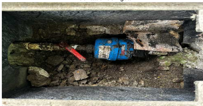
Contador de Agua
