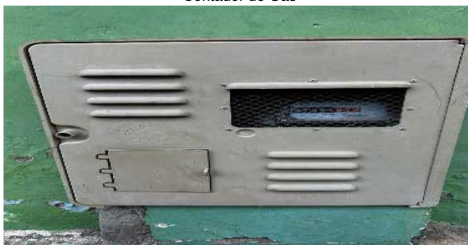
Contador de Gas
