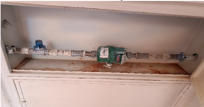
Contador de Agua
