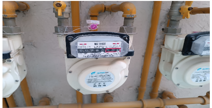
Contador de Gas
