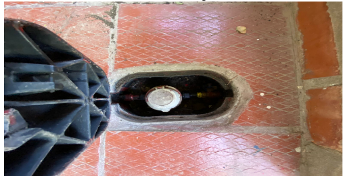
Contador de Agua
