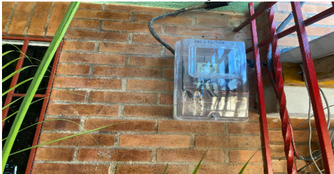
Contador de Energia
