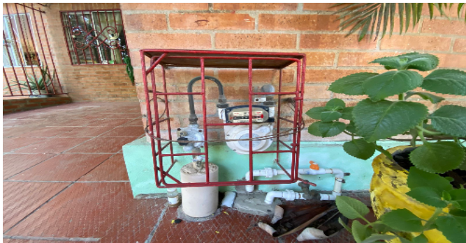
Contador de Gas
