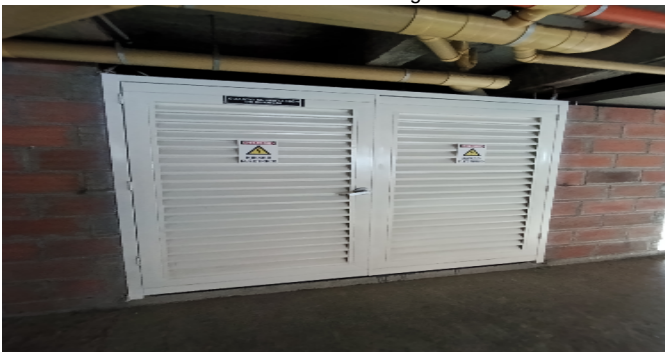
Contador de Energia
