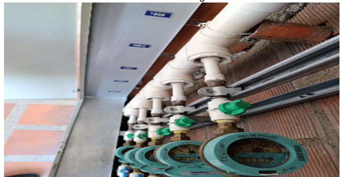
Contador de Agua
