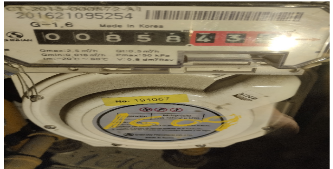
Contador de Gas
