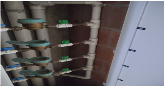
Contador de Agua
