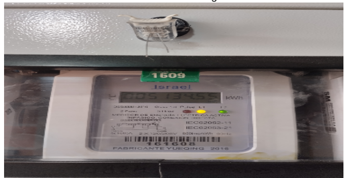
Contador de Energia
