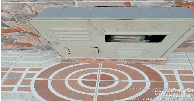
Contador de Gas
