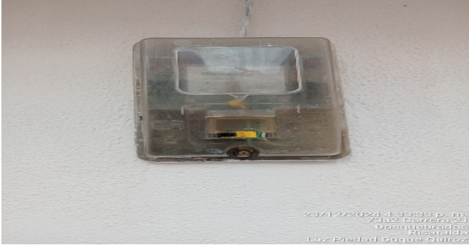
Contador de Energia
