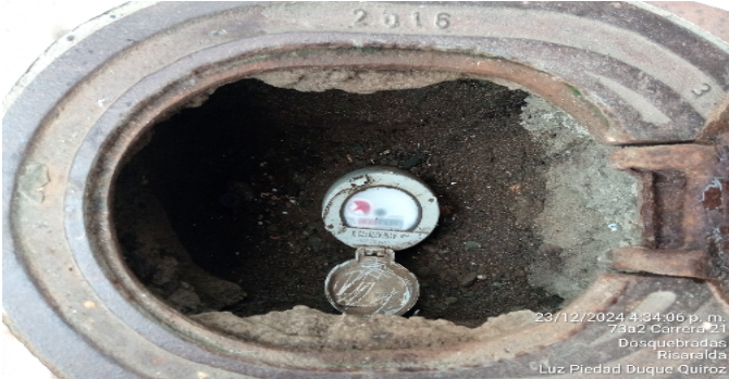
Contador de Agua
