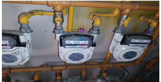
Contador de Gas
