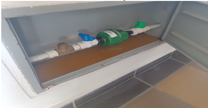
Contador de Agua
