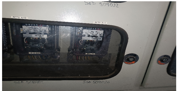
Contador de Energia
