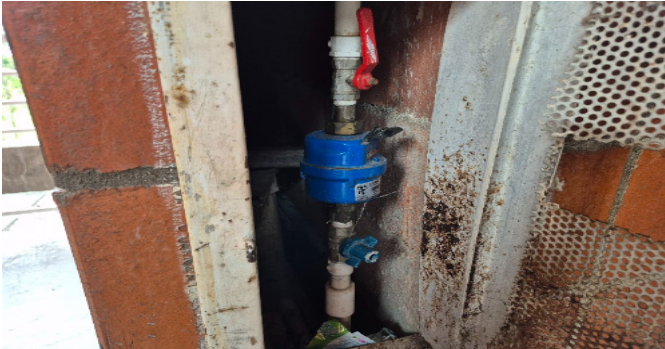
Contador de Agua
