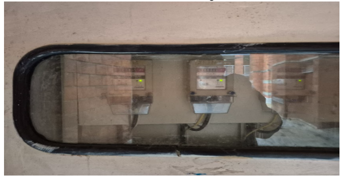
Contador de Energia
