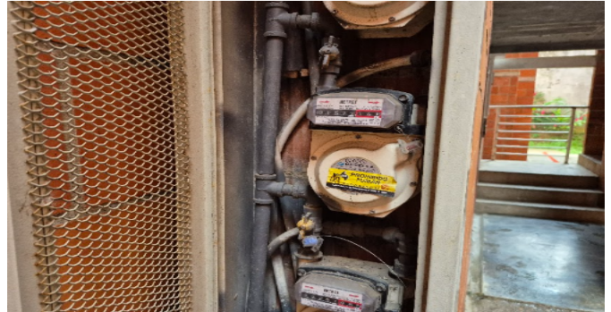
Contador de Gas
