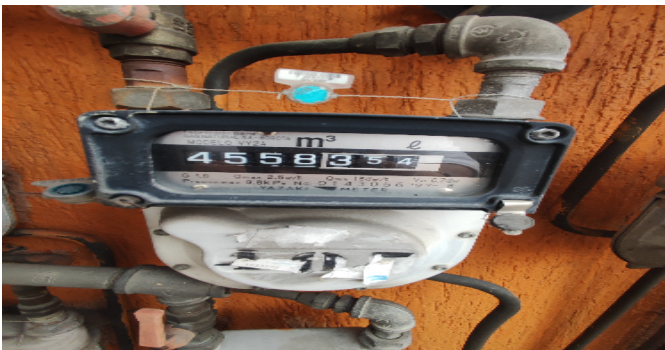
Contador de Gas
