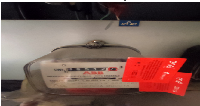
Contador de Energia
