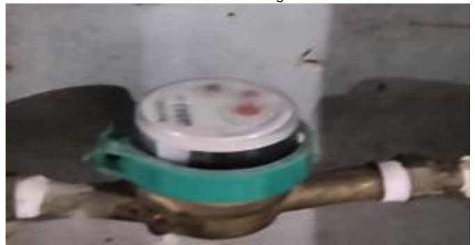
Contador de Agua
