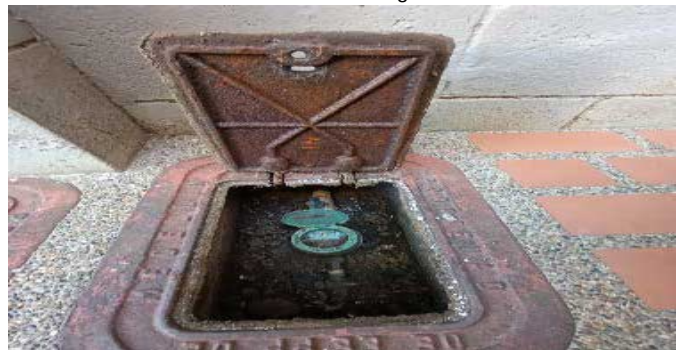
Contador de Agua
