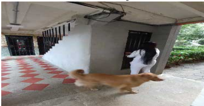
Contador de Energia
