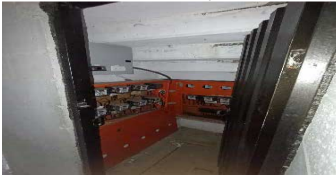
Contador de Energia
