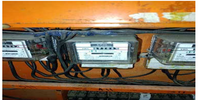
Contador de Energia
