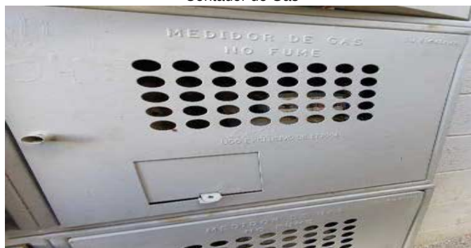
Contador de Gas
