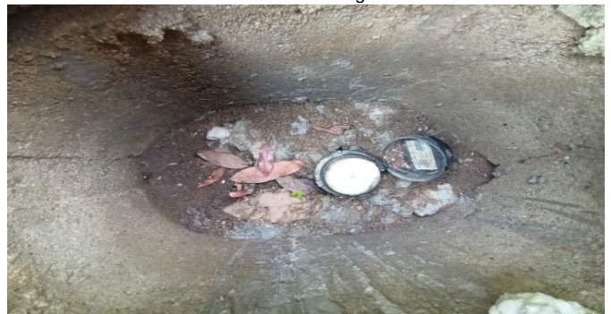
Contador de Agua
