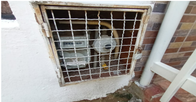
Contador de Gas
