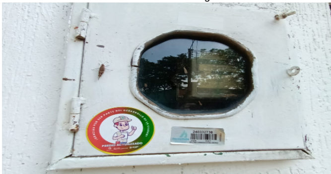
Contador de Energia
