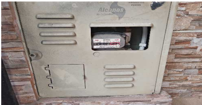
Contador de Gas
