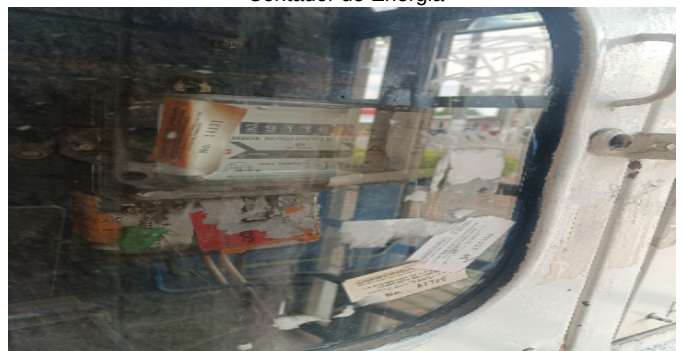
Contador de Energia
