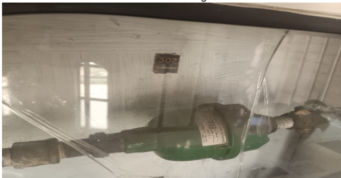
Contador de Agua
