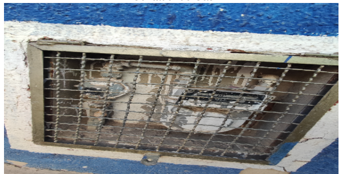
Contador de Gas
