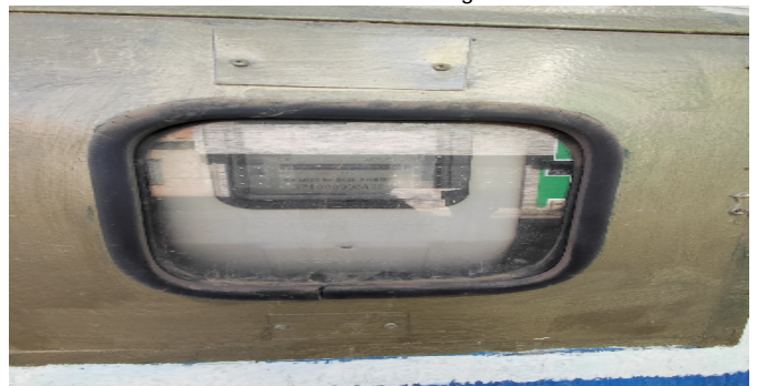
Contador de Energia
