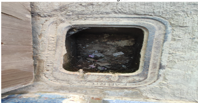
Contador de Agua
