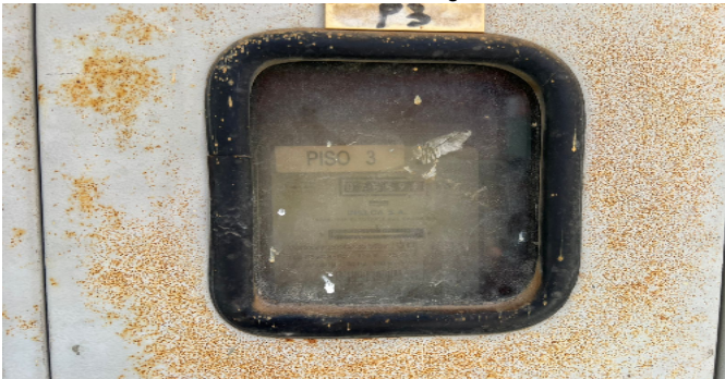
Contador de Energia
