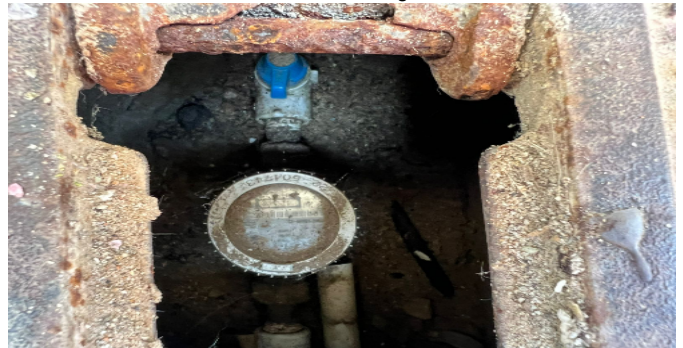
Contador de Agua
