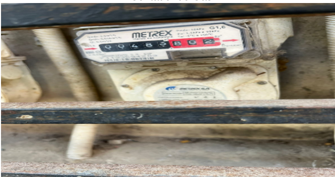
Contador de Gas
