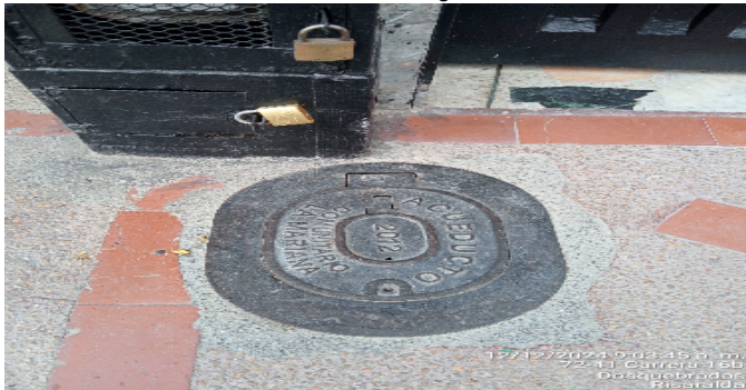
Contador de Agua
