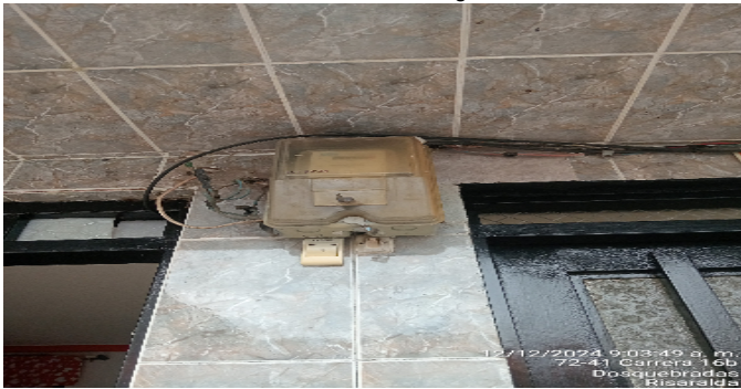
Contador de Energia
