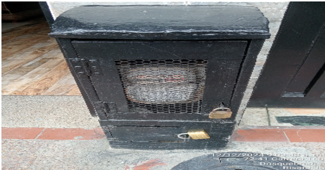
Contador de Gas
