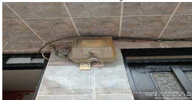
Contador de Energia
