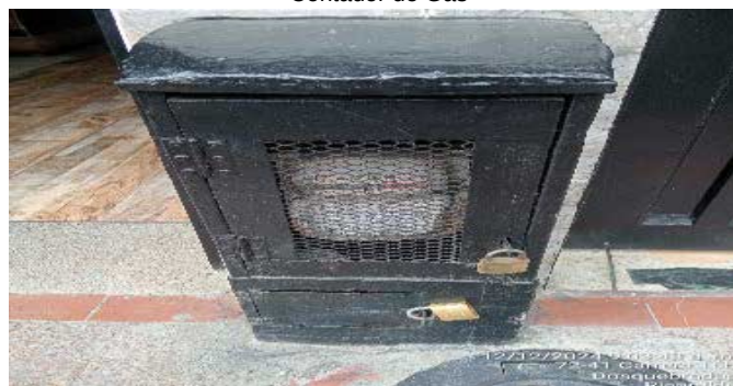
Contador de Gas
