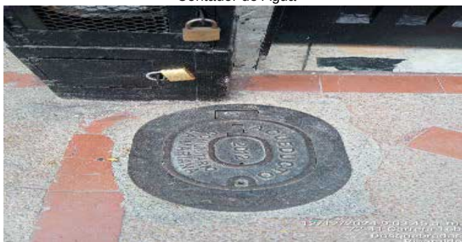
Contador de Agua
