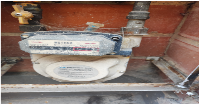
Contador de Gas
