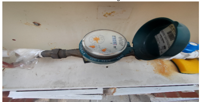
Contador de Agua
