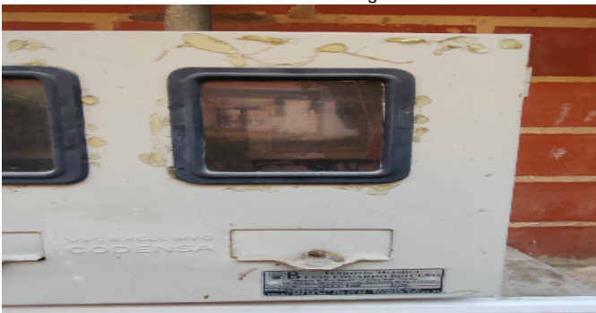
Contador de Energia
