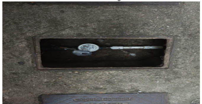
Contador de Agua
