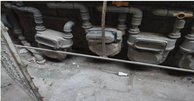
Contador de Gas
