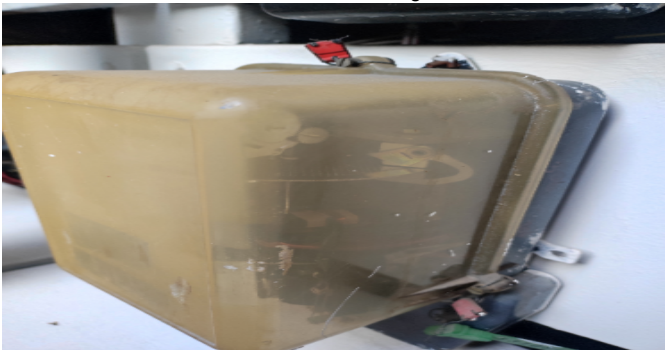
Contador de Energia
