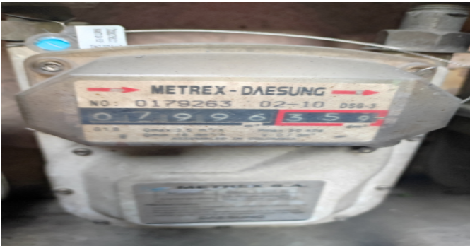
Contador de Gas
