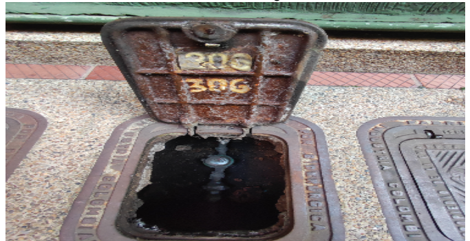
Contador de Agua
