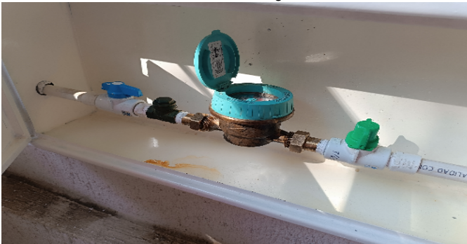
Contador de Agua
