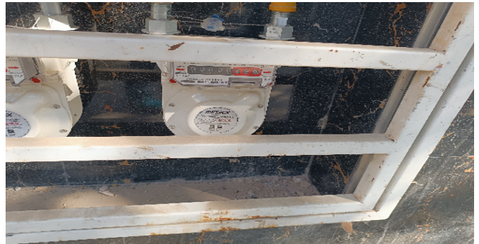
Contador de Gas
