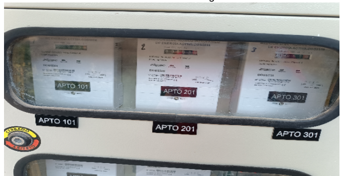
Contador de Energia
