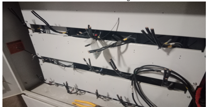
Contador de Energia
