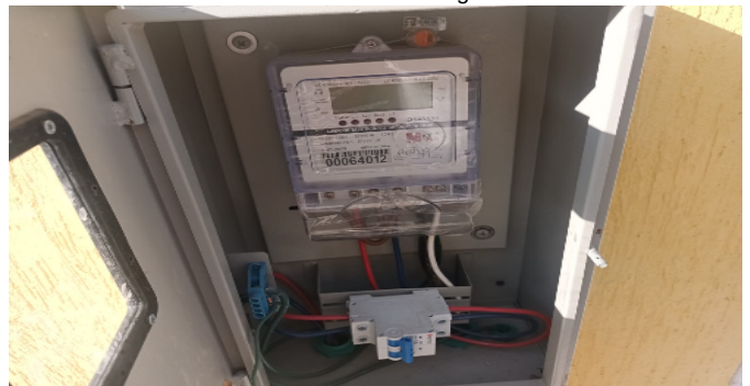
Contador de Energia
