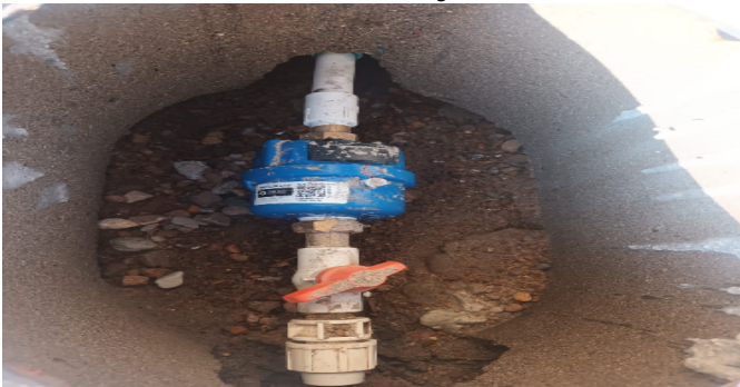
Contador de Agua
