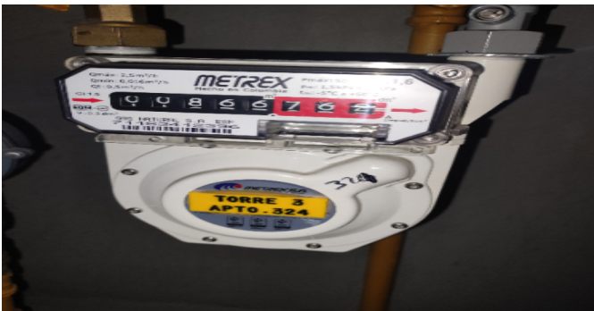
Contador de Gas
