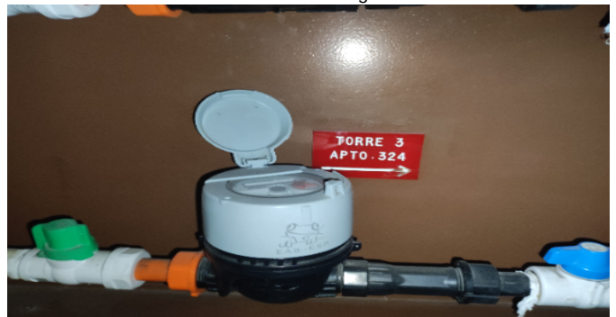
Contador de Agua
